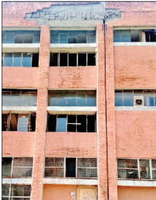
सोनीपत। मुरथल विश्वविद्यालय में खस्ताहाल कैमिकल ब्लॉक भवन, क्रिकेट अकादमी में कमरे, टूटे दरवाजे व खिड़की, छात्रवास भवन में जर्जर लेंटर, दीवारें व परिसर में अधूरा पड़ा पार्किंग क्षेत्र का निर्माण।
